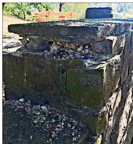
Der Schaden geht in die Tausende.
